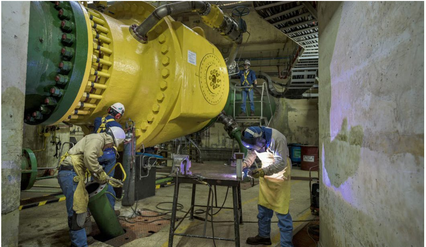
Casa de Máquinas, Central Chivor
